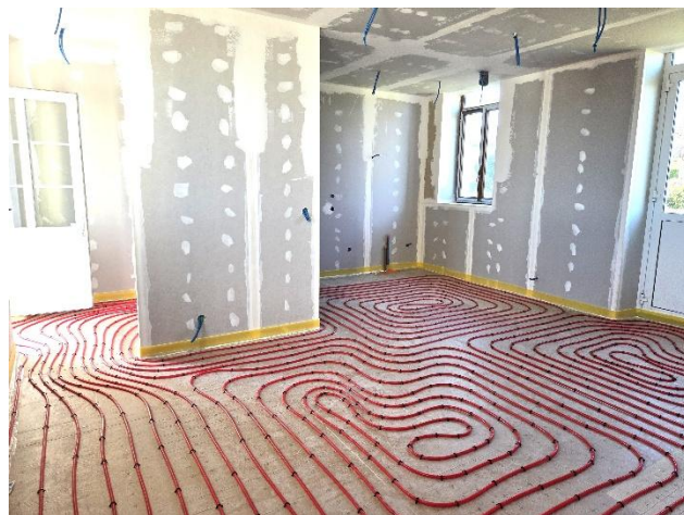
Système de chauffage au sol
